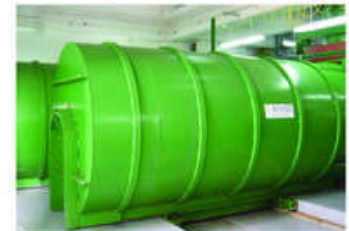
⑦ 垃圾罐- 中央收集站内,垃圾与输送空气分离后将被压入密封的垃圾罐内,等待最终处理。
