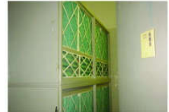
⑧ 空气过滤室- 垃圾输送气体将在过滤室内经过除尘、除臭等净化措施后,才会排出到外界大气中。
