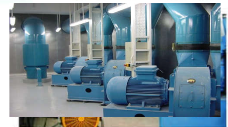
③ 抽风机- 安置在中央收集站内的抽风机为垃圾输送提供了强大的空气动力。
