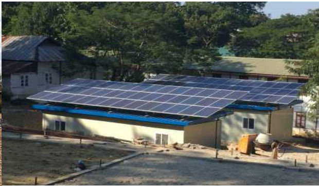
◎ 缅甸 165kW Solar+1.4MWh ESS+110kW Diesel (2017年)
