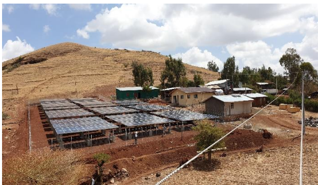
◎ 埃塞俄比亚 250kW Solar+1MWh ESS+30kW Diesel (2018年)
